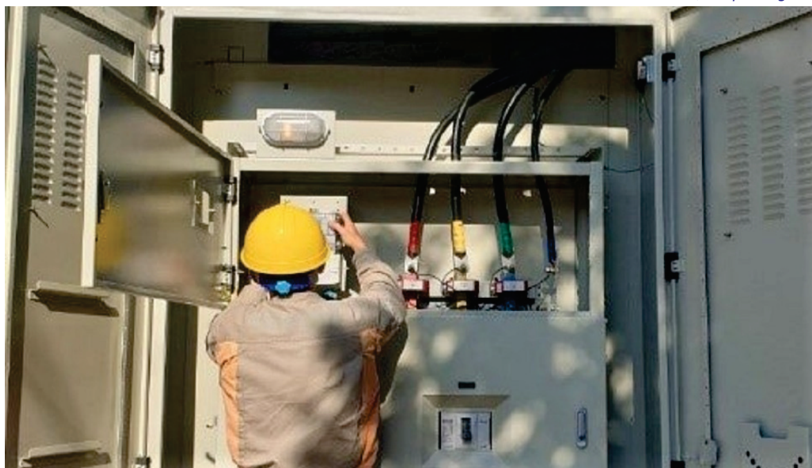
Đóng điện TBA Nguyễn Du 11 - TP Việt Trì để chống quá tải cho khu vực phát triển phụ tải cao tại Phố Nguyễn Du (Thành phố Việt Trì)
